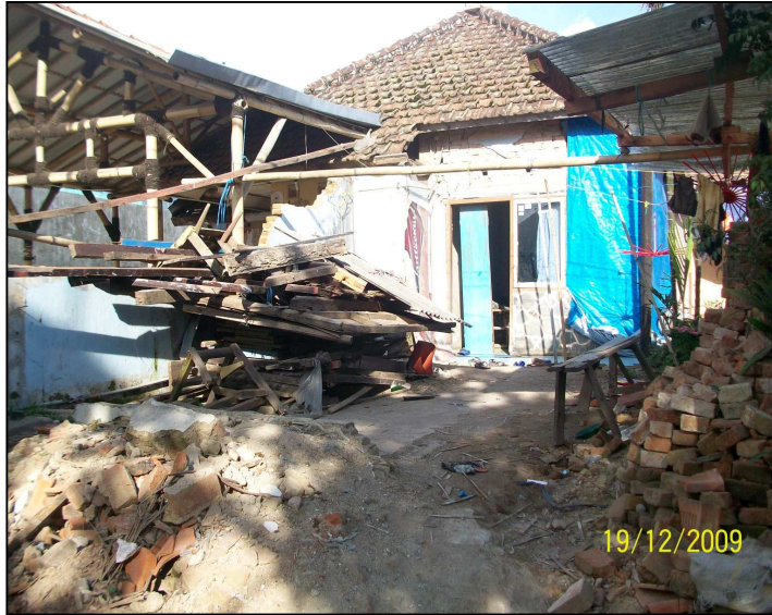
Gambar 7 : Foto rumah /bangunan permanen yang rusak berat terlihat tanpa struktur tulang beton
