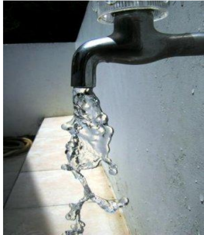
Gambar 4.5: Fasilitas air bersih dalam rumah
