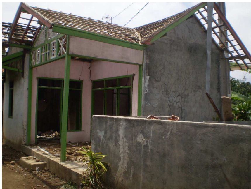
Gambar 10 Keadaan Rumah Penduduk di Kampung Parabon Pasca Gempa Bumi
