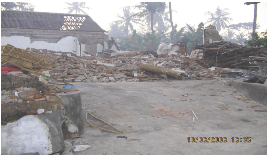
RUMAH PENDUDUK YANG SUDAH DIROBOHKAN. BANGUNAN
