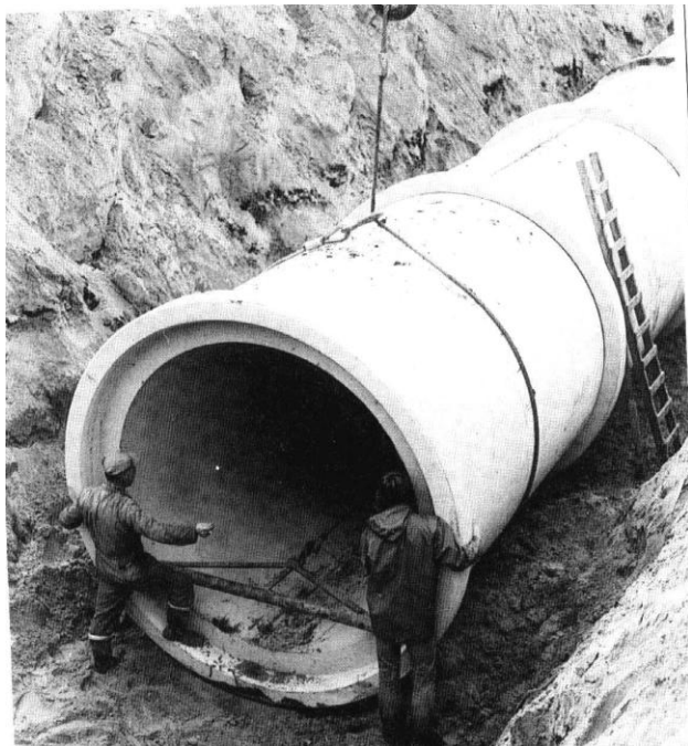
Gbr. 4 Pipa riol ukuran besar
